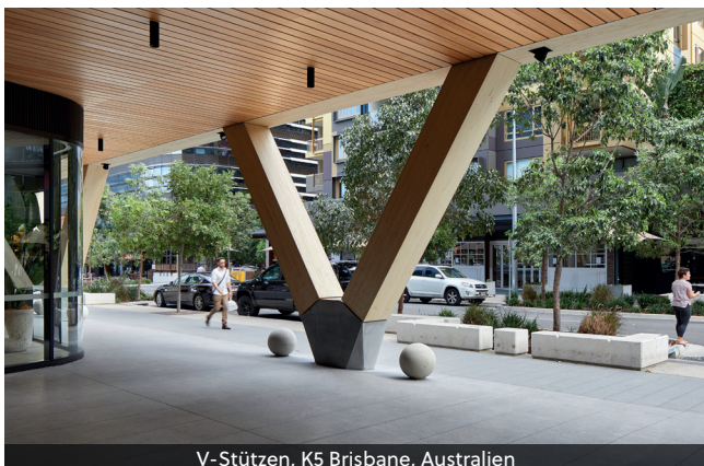
V-Stützen, K5 Brisbane, Australien
